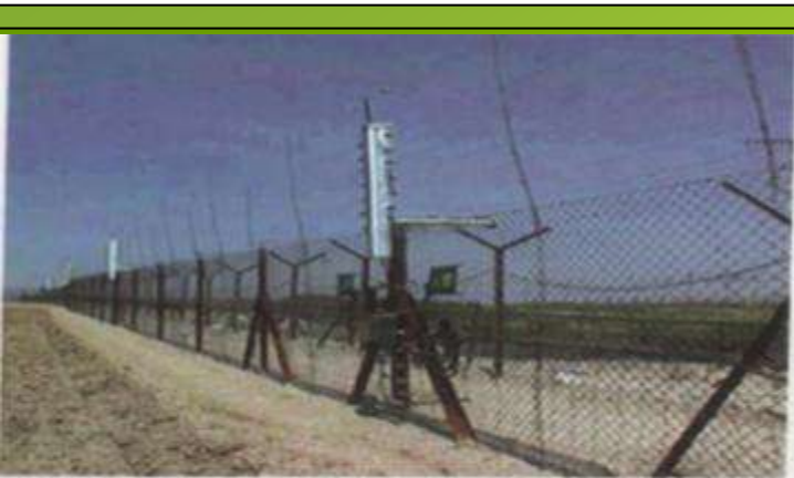
בניית גדר מערכת חדשה ועבודת האחזקה השוטפת של מאחזקי הגדרות מונחה אתגר סבצעי לחיילי חיל החימוש.
